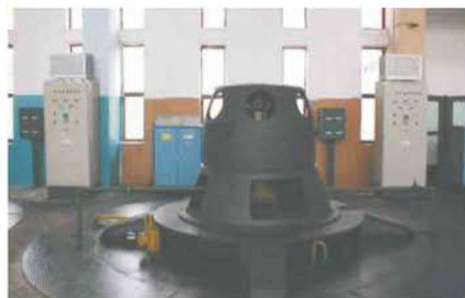
Fig. 2. Fotografie a interiorului stației de pompare. Se observă în prim plan excitatoarea unui motor sincron, iar în plan secund două dulapuri ECMS.
